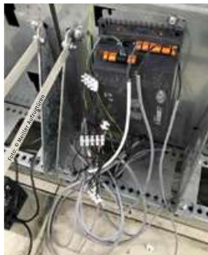
Negativbeispiel: unzulässige Verdrahtung ohne Easy Installation Kit / Negative example: impermissible wiring without Easy Installation Kit
